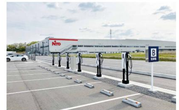
駐車場に設置されたEV充電設備
