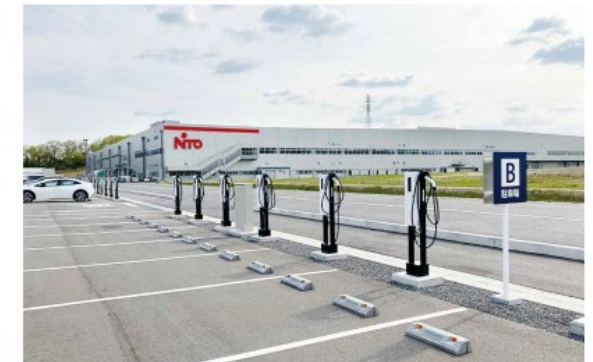
駐車場に設置されたEV充電設備
