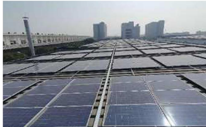
Fujitsu General Central Air-Conditioner (Wuxi) Co.,Ltd. 屋上の太陽光パネル（2020年8月稼働）
