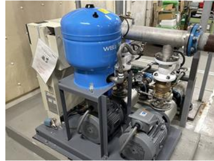
工場内給水用ポンプ
