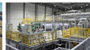
10MWの水電解装置 (出典) 旭化成(株)
