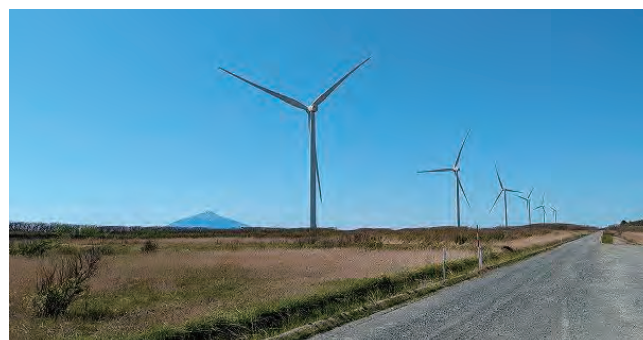
図 13 運転中の陸上風車 (北海道 幌延町、SGRE 製 4.3MW)
