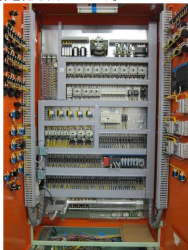
図28 制御盤内部の例
