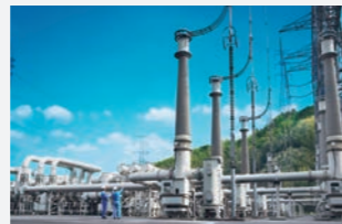
550kV ガス絶縁開閉装置
