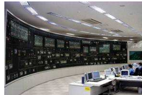
電力系統監視制御システム
