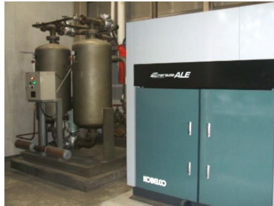
■ コンプレッサーとエアードライヤー
