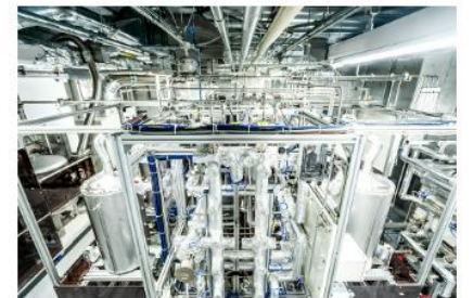
CO 2 循環プラント内の設備
