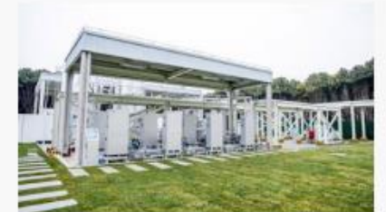
PECWで設置された純水素燃料電池
