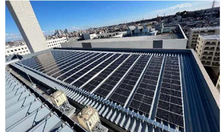
本社ICC棟屋上の太陽光パネル （2022年3月稼働）
