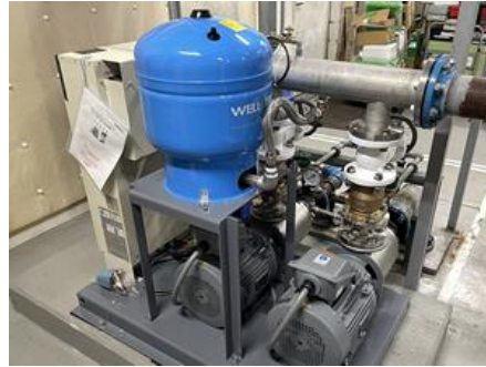
工場内給水用ポンプ
