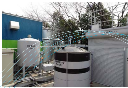
バイオマスプラント
